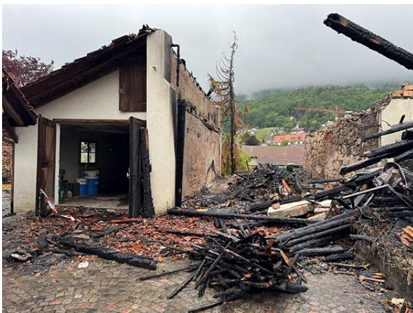
Ruine der Remise, Foto Daniel Schulz 2025. Die rechte Stallwand war die urspr. Aussenwand. Die Garage ist an die Wand der Remise angebaut.
